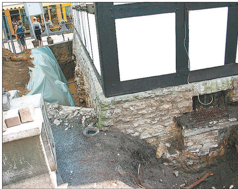
Die Kellerwände des Storck-Hauses sind feucht geworden. Sie werden in den kommenden vier Wochen saniert. Foto: Dunja Henkenjohann
